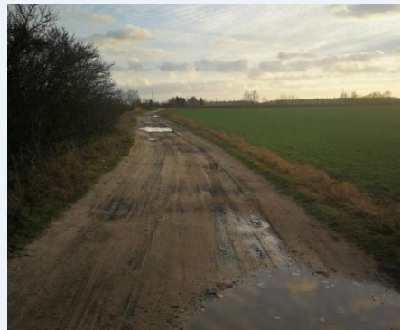
Blick 1: Blick in Richtung Süden, schlechter Zustand
