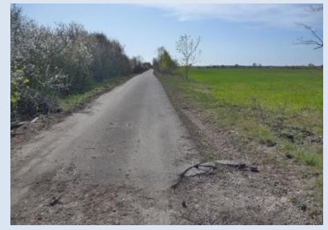
Richtung Vinzelberg: Wechsel aus Asphalt und gebundener Decke. Im letzten Bereich am Bahnhof teilweise grobes Pflaster
